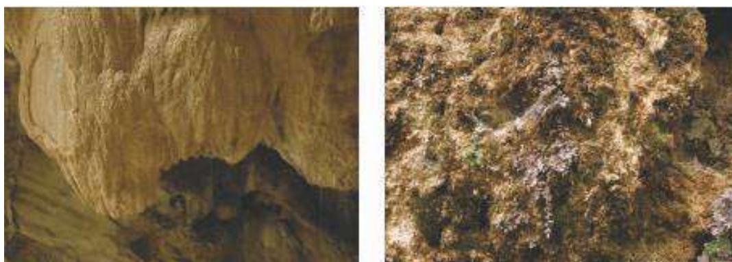
Figura 36 – (*) Incrostazioni di travertino
